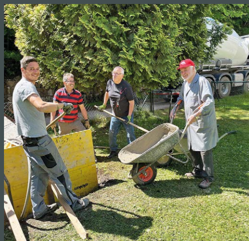
Am April 2024 begannen die Sanierungsarbeiten am Sockel des Museums und den Stützen des Fördergerüsts. Diese Arbeiten sind inzwischen weit fortgeschritten.
